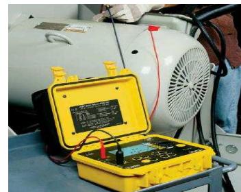
kontroli izolrezistancon de motoro per megommetro
